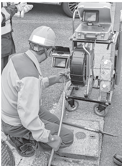
写真－２ 下水道施設損傷状況確認
