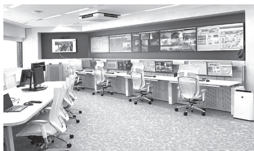
写真ー1 新規設置した神奈川集中監視センター
